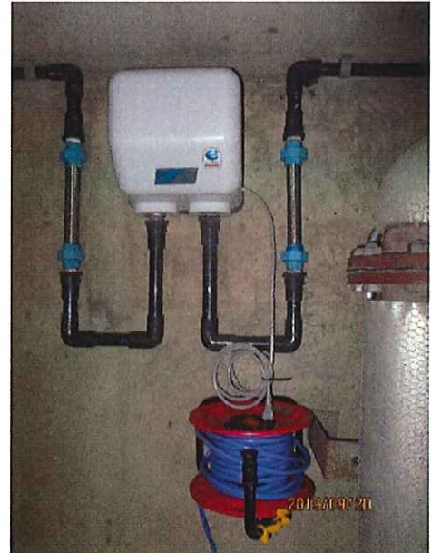
④ホームポンプのプラグを電工ドラムのコンセントに挿入する
