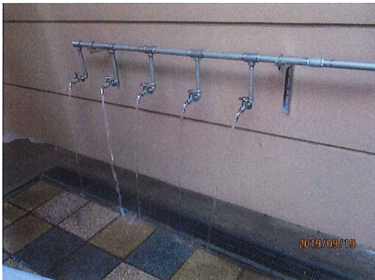
⑤屋外の蛇口を開けるとホームポンプが自動運転し、給水される
