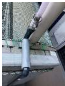
排水管の横に隙間があります。
